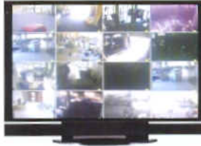
Kontrol Merkezi / Control Center
