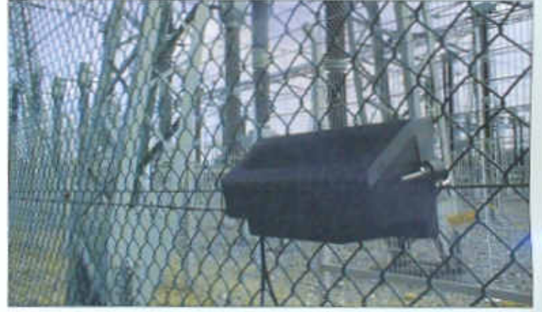
Tel Üstü Algılama Sistemi / Sensor Cable Detection System
